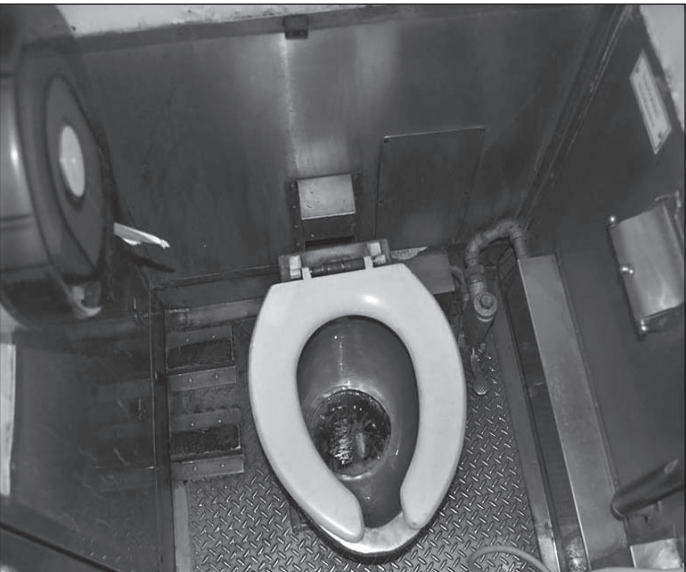
Bahn-WC: „Auf die Situation einstellen“
