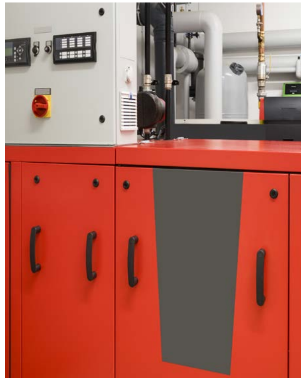
In Ihrem Heizungskeller können Sie mit einem kleinen Blockheizkraftwerk auch Ihren eigenen Strom erzeugen.
