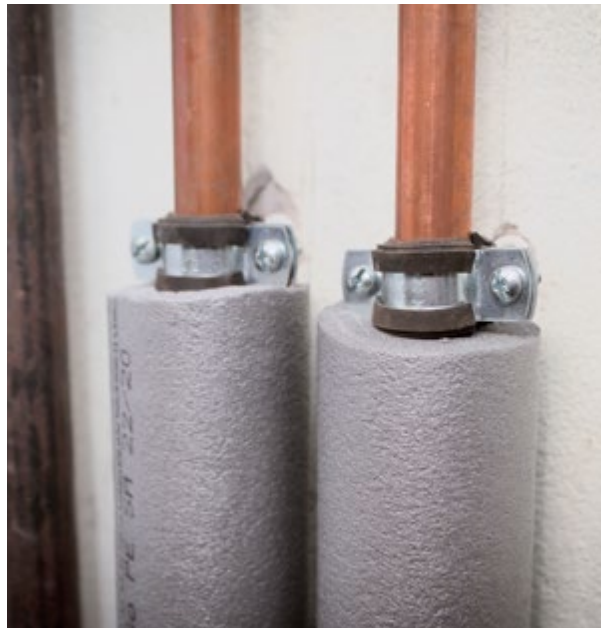
Eine lückenlose Rohrdämmung macht sich schnell bezahlt.
