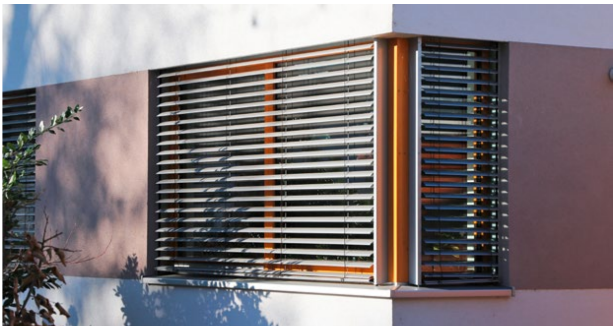
Raffstores als außen angebrachter Sonnenschutz.
