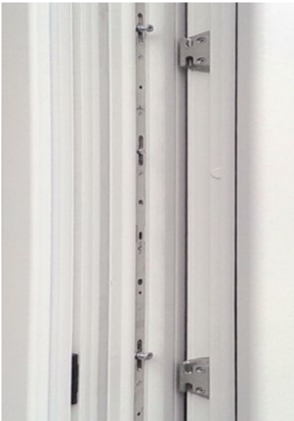
Eine Pilzkopfverriegelung sichert das Fenster zusätzlich.
